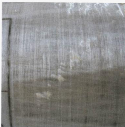
图 B.2 磨损(一级损伤)
