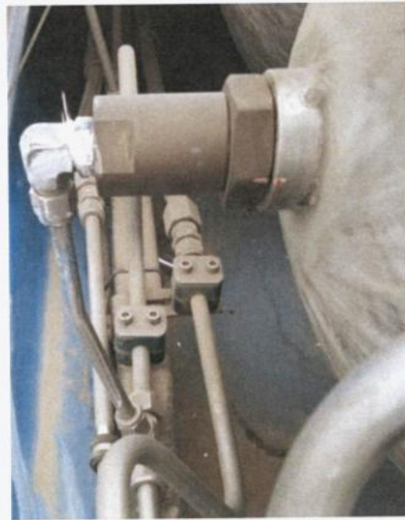
图 B.16 管路损伤
