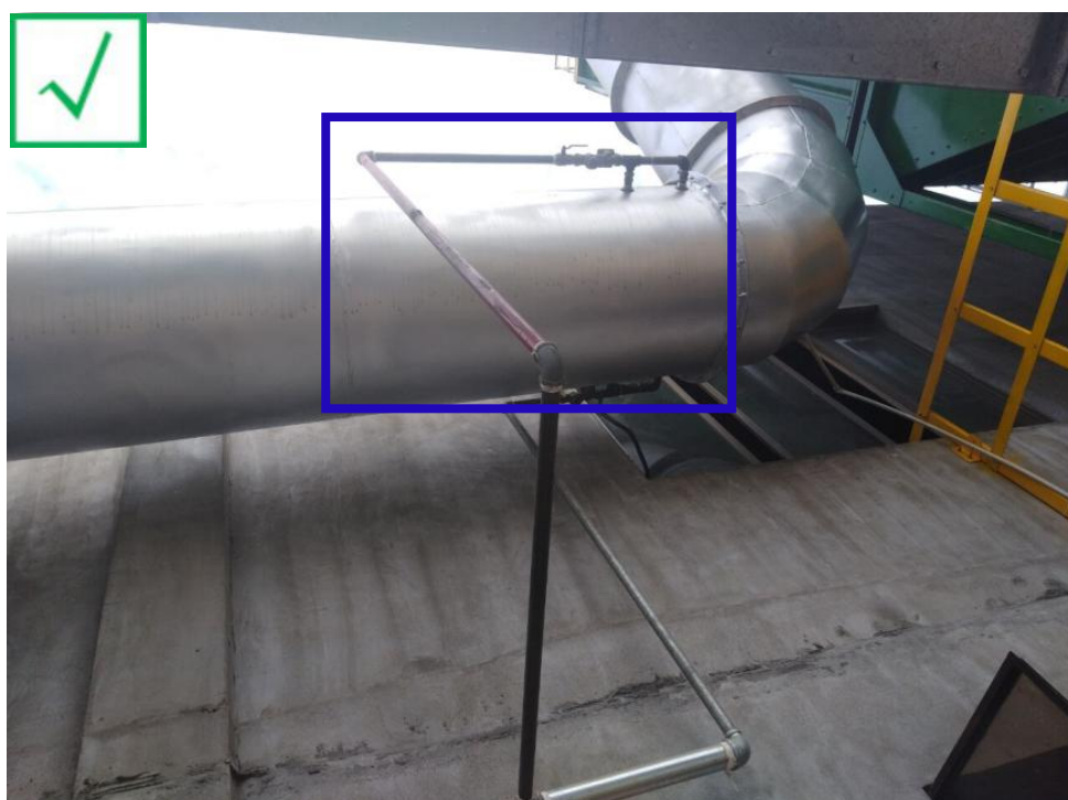
情景描述：此图为木粉尘除尘系统火花熄灭喷淋管。
