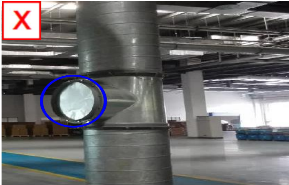
隐患描述：管道泄爆设置在车间内。
