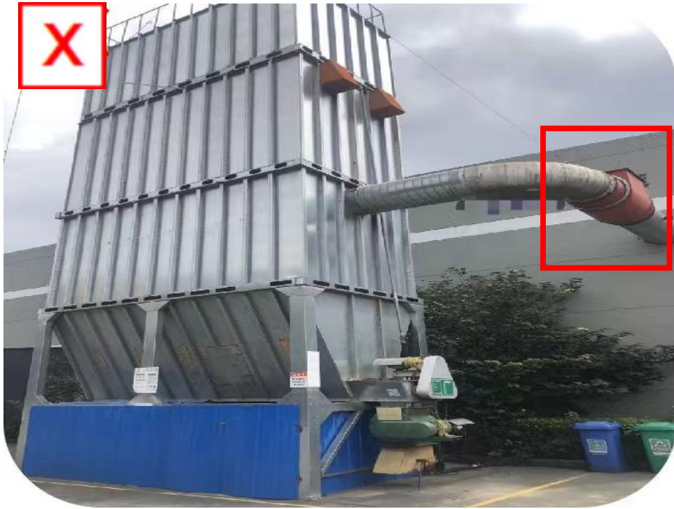
隐患描述：隔爆阀未可靠支撑固定。
