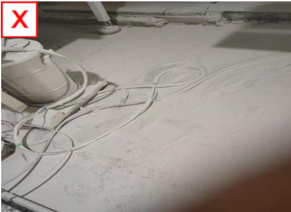
隐患描述:除尘系统风量不足, 粉尘外溢, 喷粉房粉筒周边积尘严重。
