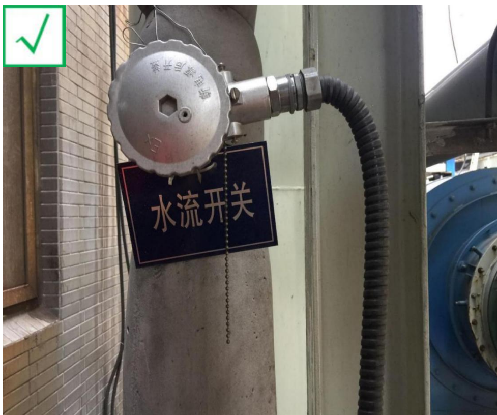
情景描述：湿式除尘器进水管水流量监测。
