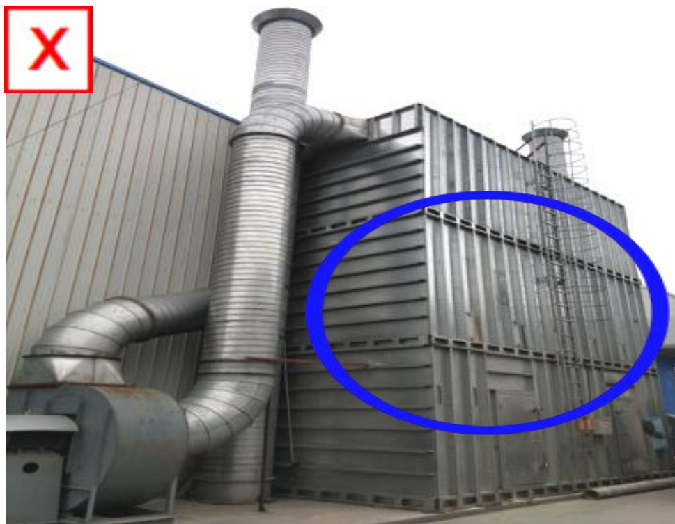
隐患描述：采用重力沉降除尘，未设置锁气卸灰装置。
