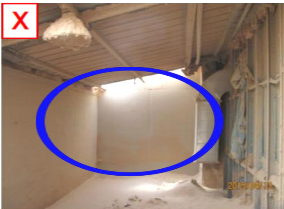
隐患描述：采用重力沉降除尘。
