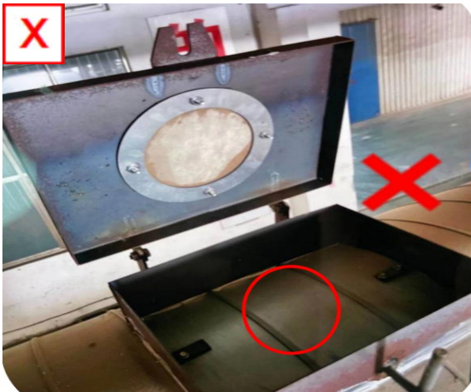
隐患描述:除尘风管未按要求设置清灰口, 设置了虚假清灰口。
