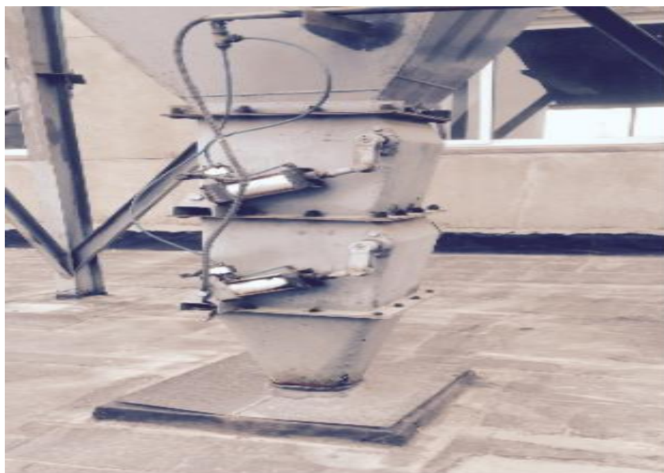
情景描述：锁气卸灰装置-双层气动翻板阀。
