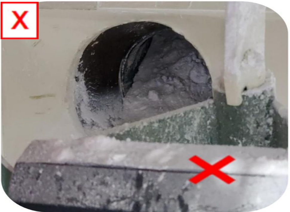
隐患描述:湿式除尘系统循环用水管道未及时清理,形成粉尘泥浆积聚。
