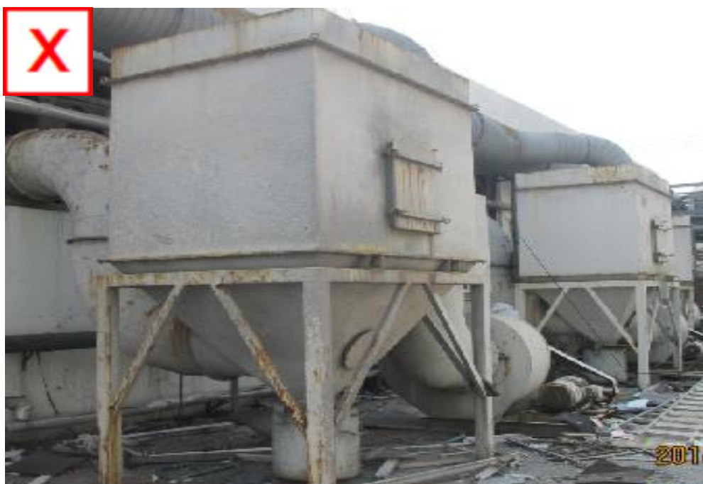
重大隐患描述：金属粉尘除尘系统无任何控爆措施。
