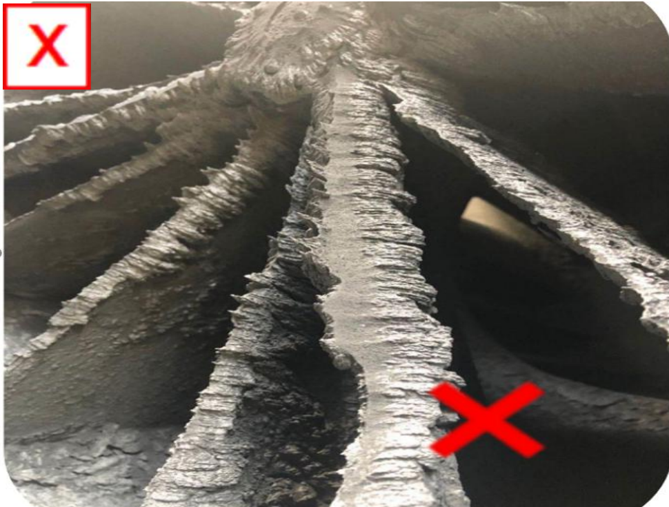
隐患描述:湿式除尘系统风机积尘严重,形成粉尘泥浆积聚。
