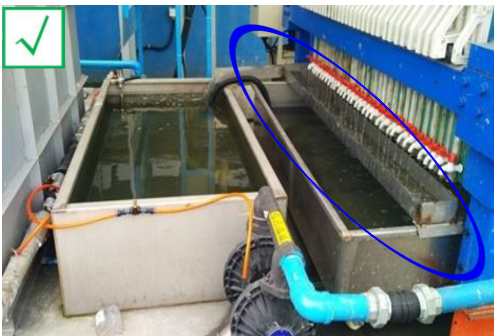
情景描述：湿式除尘器配套水箱采用压滤机进行压滤。
