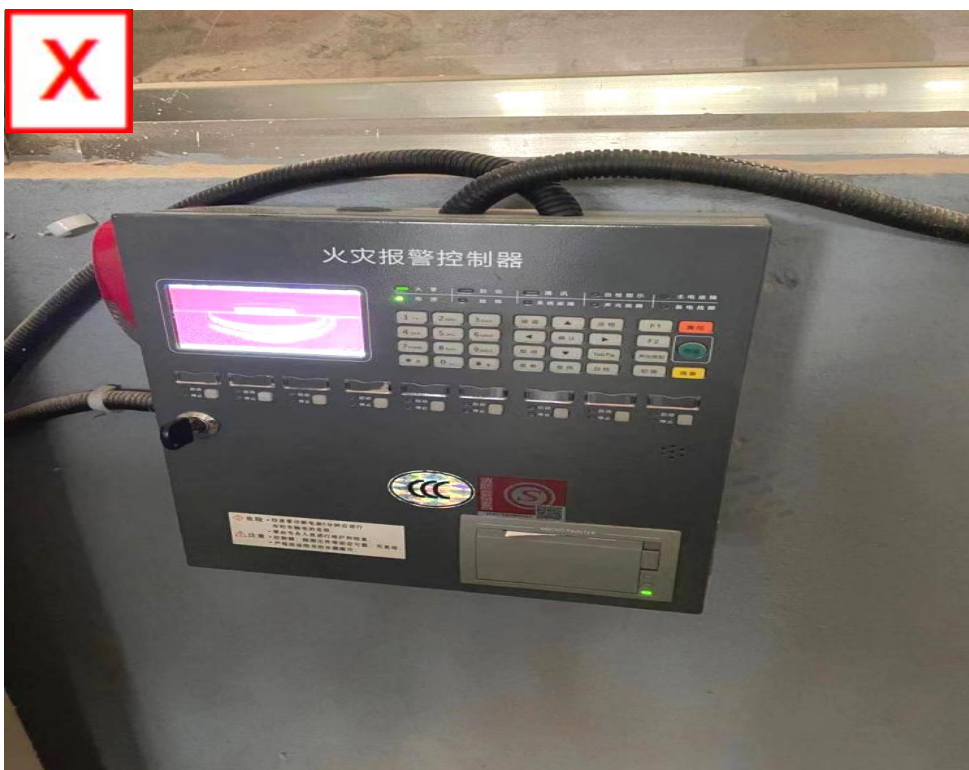
隐患描述：设置火灾报警系统代替火花探测系统（火灾报警不能代替火花探测）。
