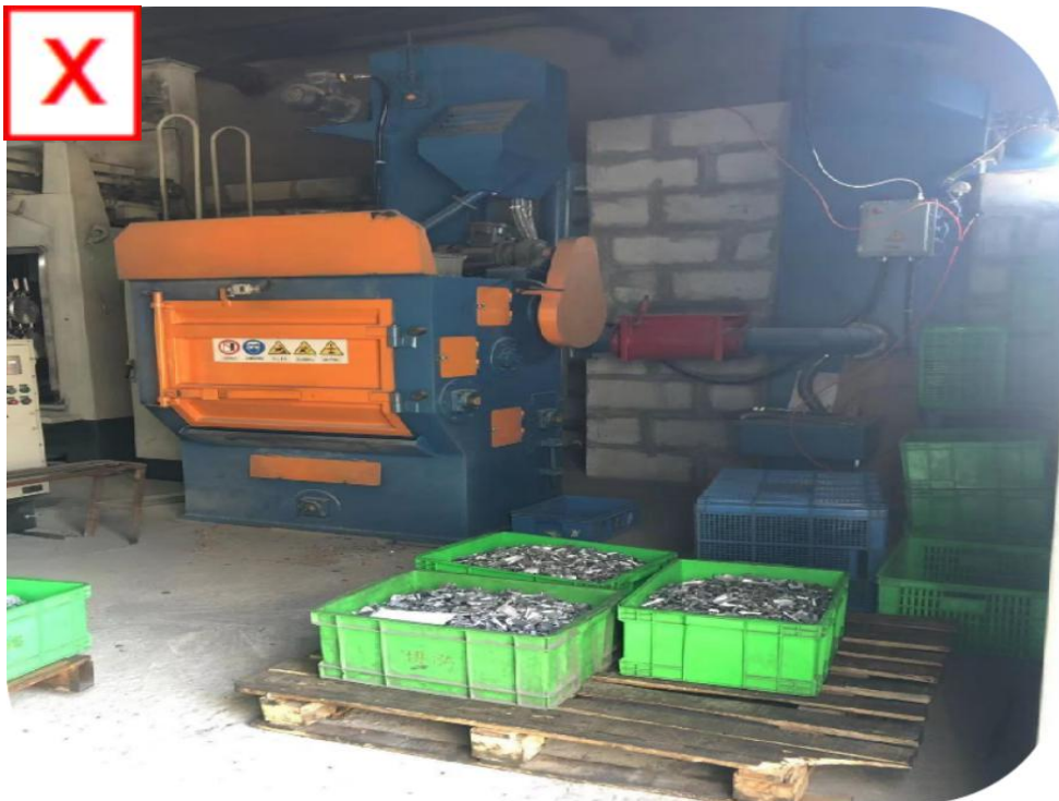
隐患描述：铝镁抛丸除尘器安装在抛丸机旁已做隔离，但防护隔离不全，隔爆阀未隔离在工作岗位以外。
