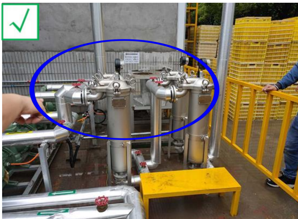
情景描述：湿式除尘水箱过滤器。
