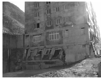
图2 挡土墙挤压建筑 底层导致破坏
