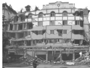
图5 底部框架-上部砖房的层2倒塌
