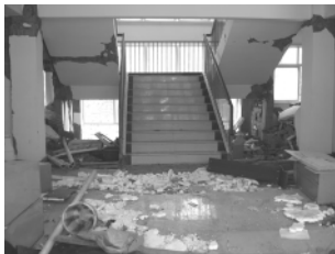
图 8 框架结构楼梯间破坏 (休息平台梁下短柱效应)
