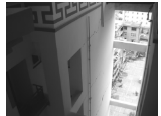
图 2 平面深凹口处两侧墙体拉弯破坏实例
