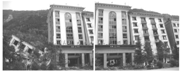
图6 由于碰撞导致建筑连续倒塌的震害
