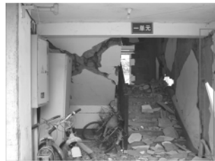
图 9 砌体结构楼梯间严重破坏 (构造柱防止倒塌)
