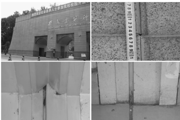
图 11 建筑物变形现状照片
