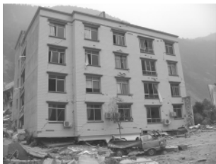
图4 底部框架-上部砖房的底层倒塌
